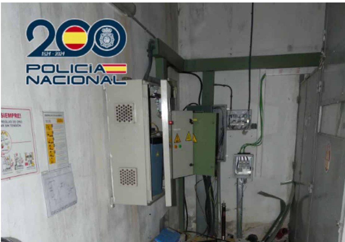
Imagen de una de las instalaciones de suministro de aguas de Alcoy atacadas por un ladrón
